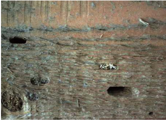
Tukkijäärän ( Monochamus ) toukkareikiä ja sinistymää laudassa. Vanhat toukanreiät ovat sallittuja. Kuva: Jyrki Tomminen
